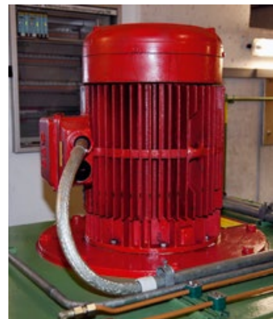
Abb. 3: Falsch dimensionierte Motoren verbrauchen viel Strom. Foto: R. Strässle
